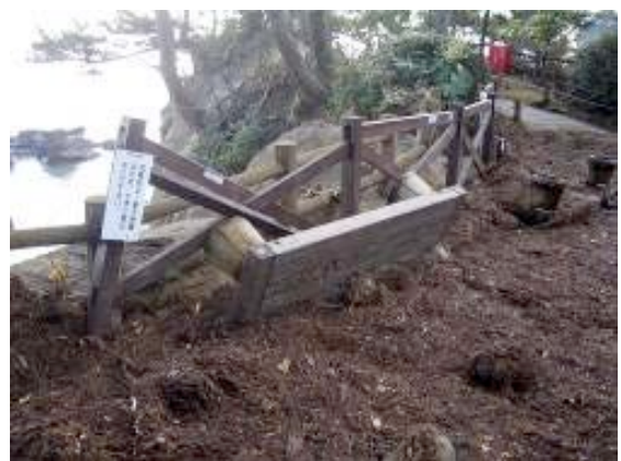
写真3 海食崖に面した庭園の津波遡上部
